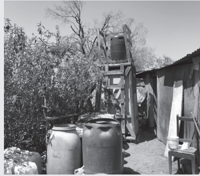
Fig. 15: Caso 2. Torre de Agua con Ducha y mejoramiento de vivienda, Comuna Santa María. V región de Valparaíso.
